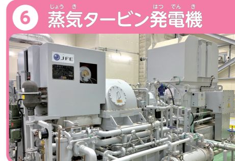
6 蒸気タービン発電機 蒸気力で羽根車を回して電気をつくります。最大1,550kW、一般家庭約3,600世帯分の電気をつくるができます。
