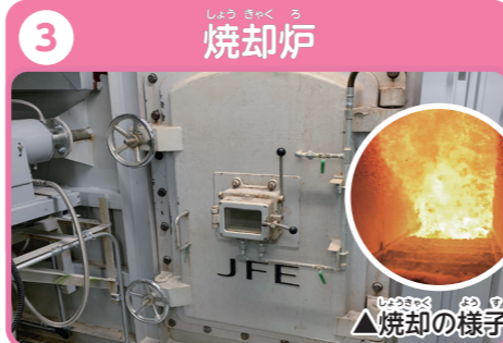
3 焼却炉 ごみを完全燃焼させて灰にします。ごみは850℃の高温で焼却することで、ダイオキシン類の発生を抑えています。
