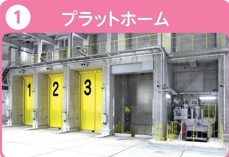
1 プラットホーム 運ばれてきたごみは、計量機で重さを量った後、プラットフォームの投入扉からごみピットに投入します。
